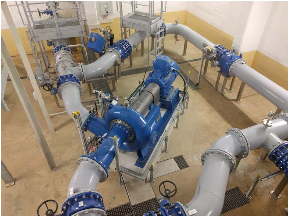
Abb. 4: Thüringer Fernwasserversorgung: Anlage Arnstadt-Espenfeld, Hochbehälter 02, Francis-Turbine, Leistung 55 kW, mit Turbinen-Bypassleitung
