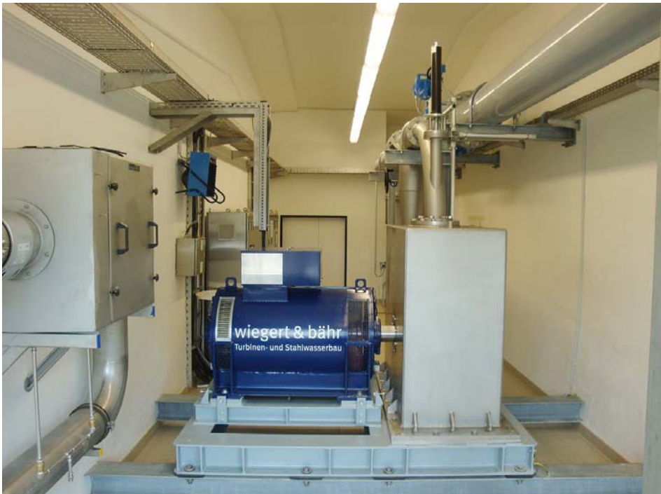
Abb. 1: Trinkwasserversorgungsanlage Obermaubach: 2-düsige Pelton-Turbine, Leistung 160 kW, mit Spezialgrundrahmen zur Krafteinleitung in das Gebäude bei gleichzeitiger Entkopplung von Körperschall
