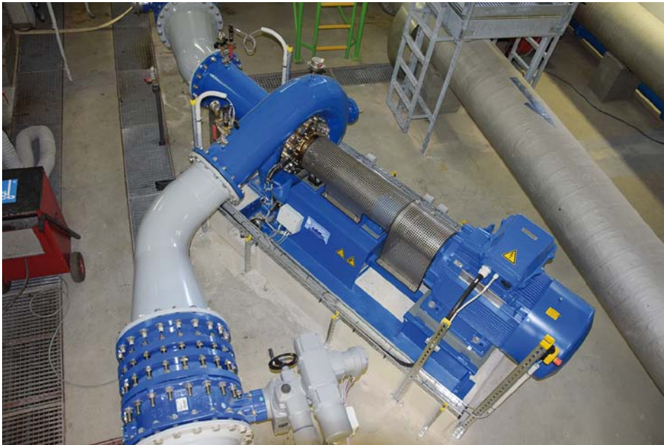
Abb. 5: Thüringer Fernwasserversorgung: Anlage Erfurt-Bienstadt, Francis-Turbine, Leistung 63 kW, nachträglich in bestehende Anlage eingebaut
