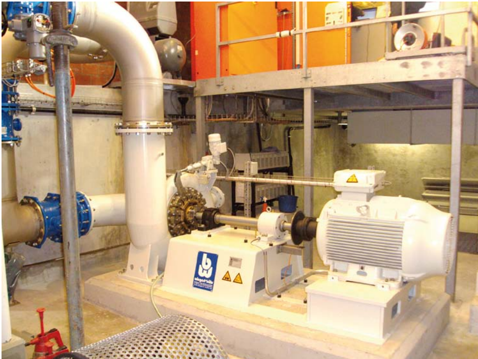
Abb. 7: Anlage Moos der Wasserversorgung Stadt Zürich/Schweiz: Francis-Turbine, Leistung 40 kW, mit elektrischer Regulierung
