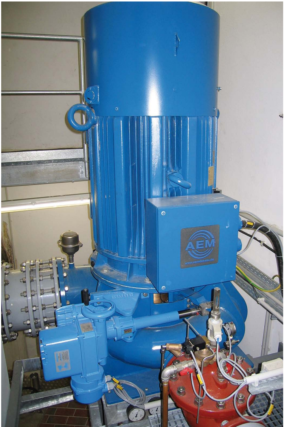
Abb. 8: Anlage Lindenberg, Harzwasserwerke: Vertikale Francis-Turbine, Leistung 124 kW, mit elektrischer Regulierung und Clayton-Ventil zur Druckbegrenzung alle Fotos: Wiegert & Bähr
